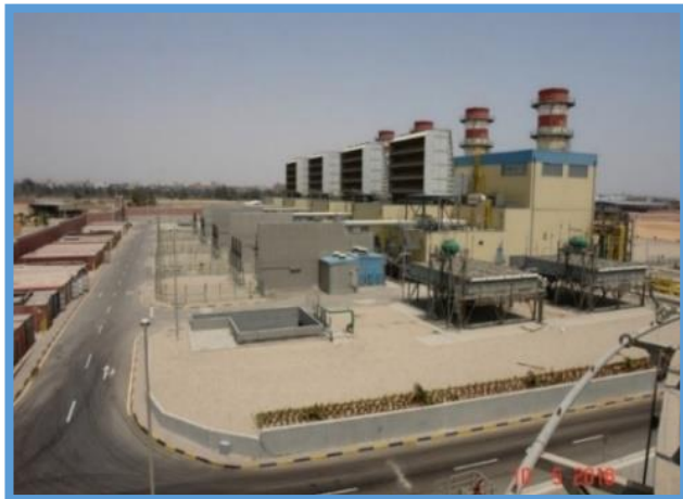
محطة توليد كهرباء ٦ أكتوبر قدرة ٦٠٠ م.وات (١٥٠*٤ م.وغازي) تم إستكمال قدرات المحطة بالكامل
