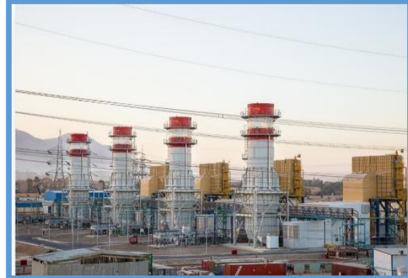
محطة توليد كهرباء عتاقة
