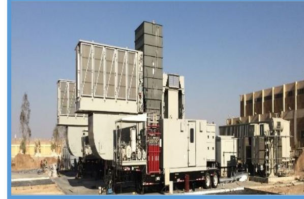
وحدات توليد الكهرباء المتنقلة
